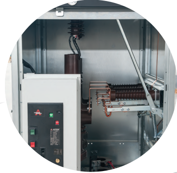
KABLO BAĞLANTI BÖLÜMÜ
